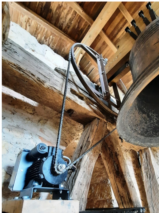
Le mécanisme motorisé de mise en volée automatique
